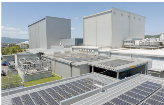
24年度に増設した自家消費型の太陽光発電設備(テクニカルセンター棟に設置)
